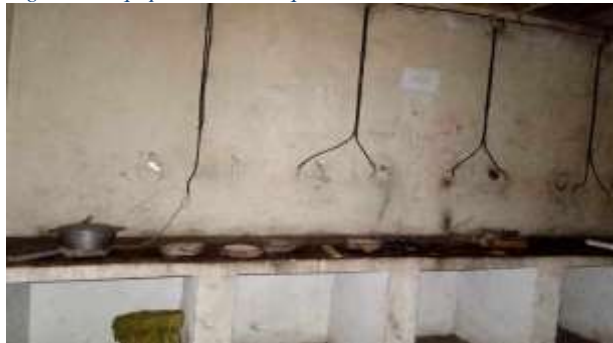
Figure 1 : équipement électrique Antananarivo
