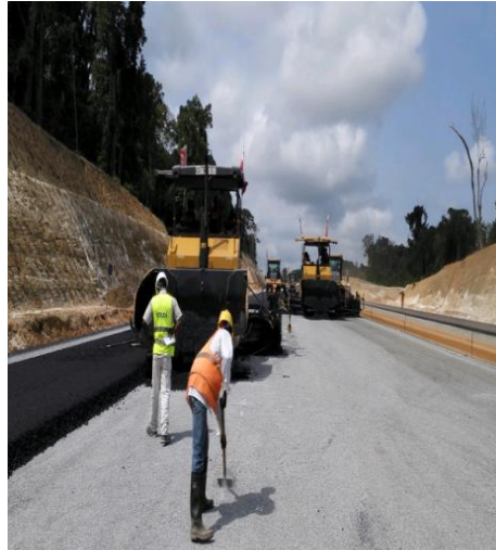
Photo 3.3 : Évolution des travaux de bitumage de l'autoroute Kribi-Lolabé Source : Cliché Roméo Aimé Kouanou, Kribi (zone rural) le 10 avril 2019
