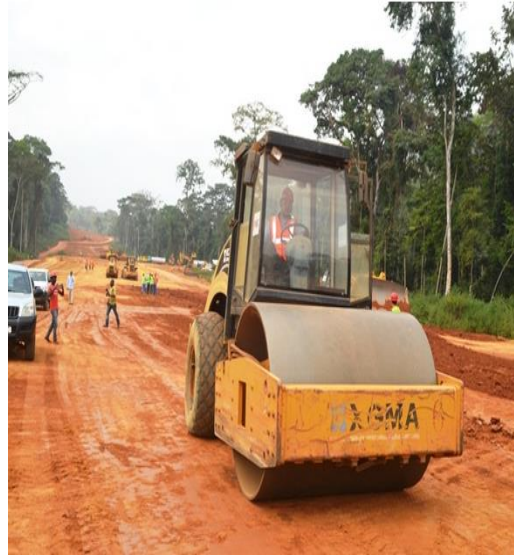
Photo 3.2 : Phase 2 de l'autoroute Yaoundé-Douala Source : Cliché, Roméo Aimé Kouanou, Bibodi le 23 décembre 2019
