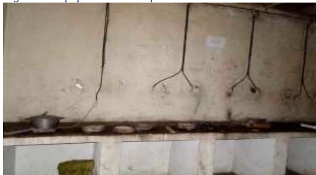
Figure 1 : équipement électrique Antananarivo
